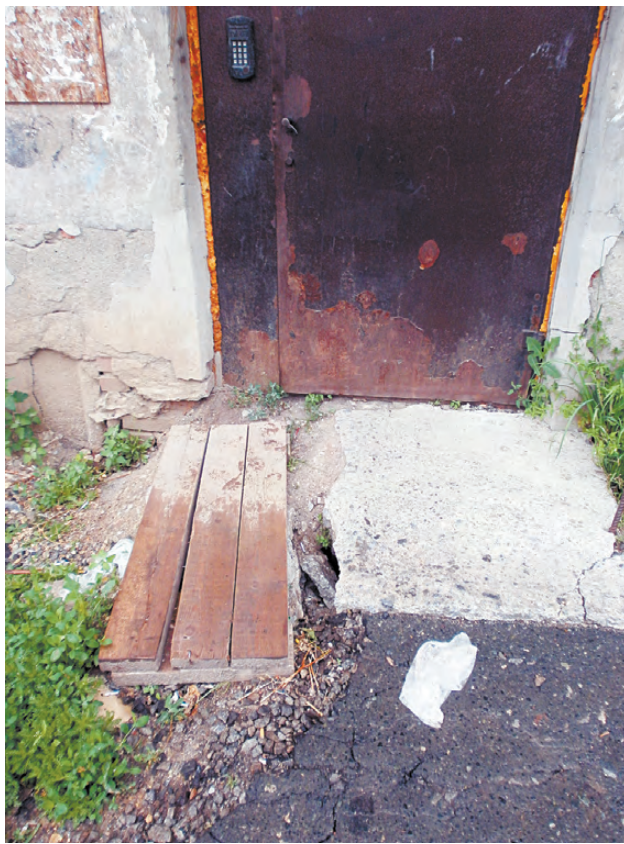
Открывая дверь подъезда, люди рискуют оступиться.
