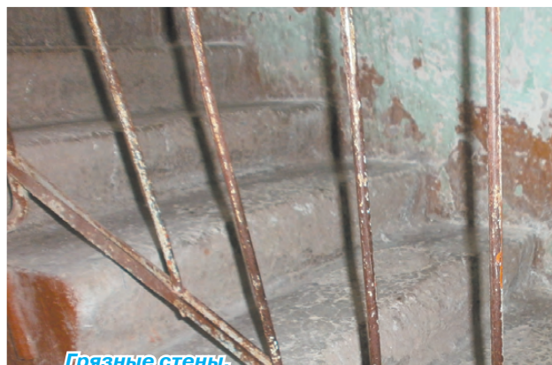
Грязные стены, ржавые перила.
