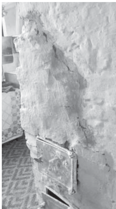
При пожаре из таких трещин повалит дым. Достаточно нескольких вдохов, чтобы отравиться
