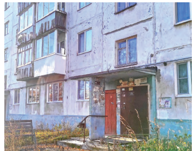
Ремонта требует не только третий подъезд дома № 2 по улице Сиротина.
