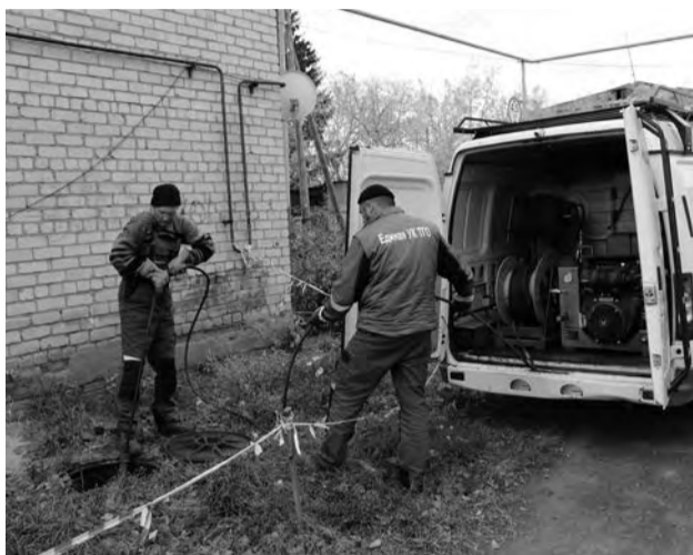
Оборудование УК позволяет оперативно устранять аварийные ситуации.
