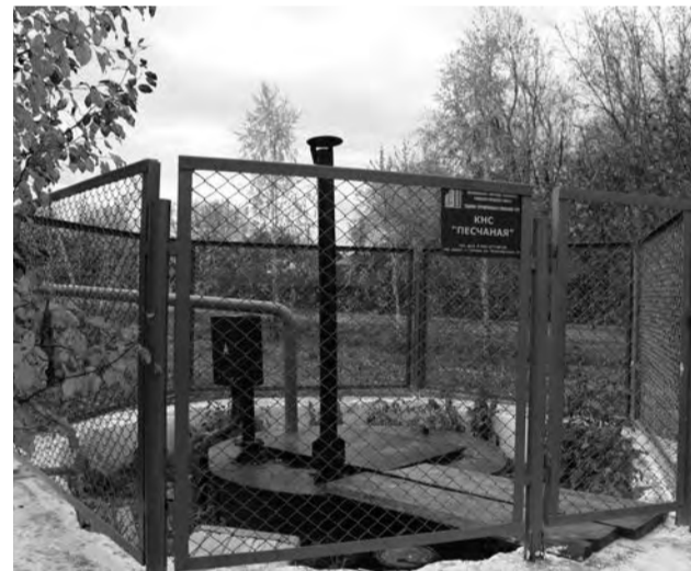
Канализационно-насосная станция «Песчаная», рассчитанная на 70 кубометров, работает в автономном режиме. Обслуживается МУП ТГО «Единая управляющая компания ТГО».
