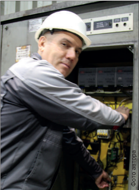
От правильной работы источников бесперебойного питания на участке подъёмно-транспортного оборудования и светотехнических установок зависит безопасная остановка подъёмных механизмов. На фото – Сергей Брусников проверяет систему зарядки
