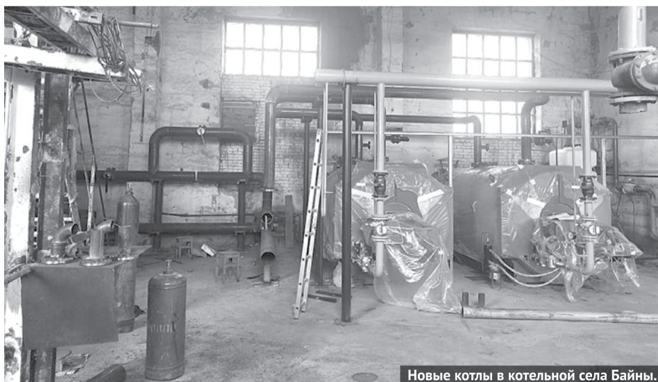
Новые котлы в котельной села Байны.
