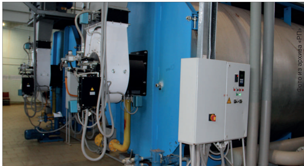
На котельной 60 МВт, построенной в 2011 году, были спроектированы два котла для нагрева воды в летний период
