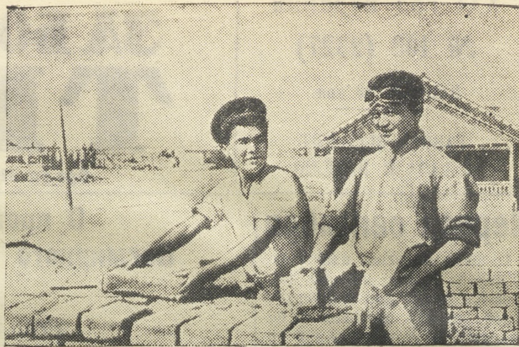
В Тахиа-Таше, где возьмет начало Главный Туркменский канал, строится новый город. В числе других сюда прибыло много выпускников школ фабрично-заводского обучения из Узбекистана и Кара-Калпакии.
