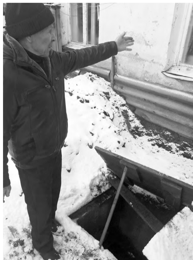
Хоть коммунальщики и закрыли провал щитом, запах канализационных стоков продолжает беспокоить жильцов.
