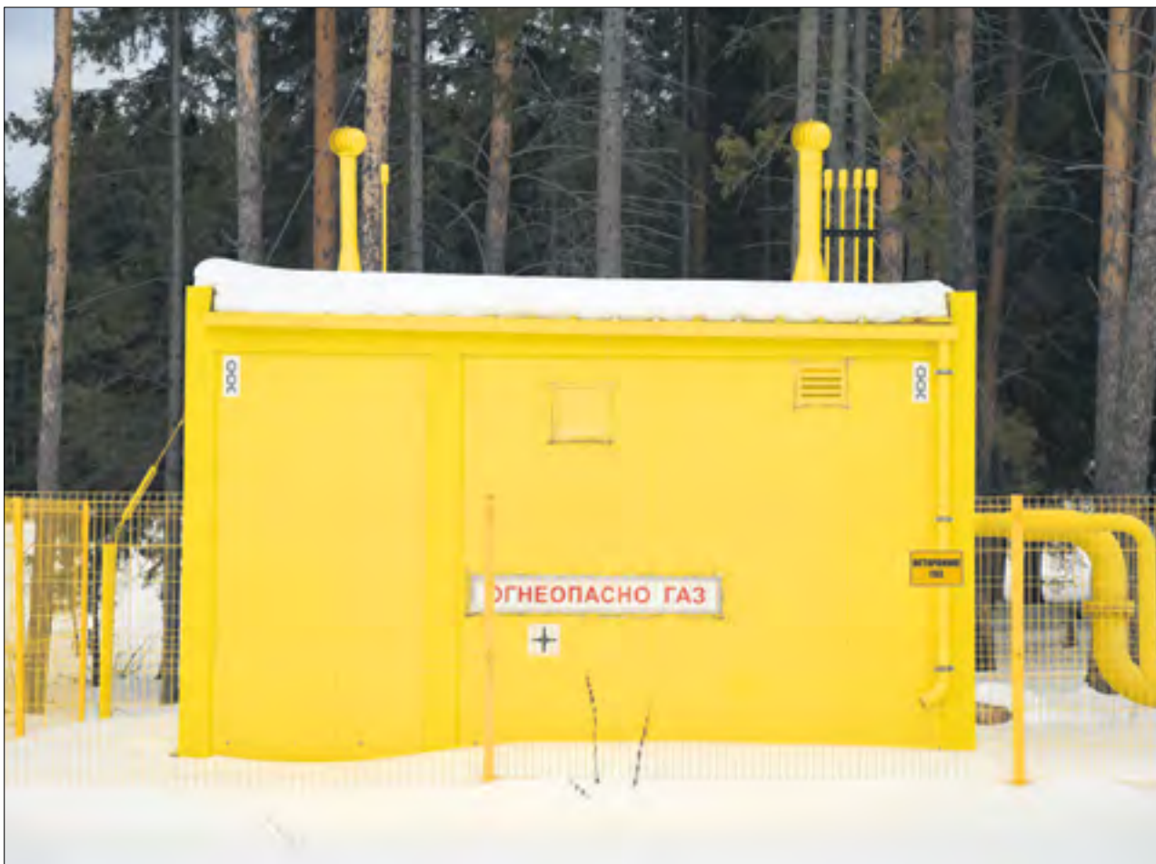
Вот так выглядит ГРП на Биатлоне. Подстанция появилась недавно, а уже скоро этот район будет полностью газифицирован. // Фото из архива редакции
