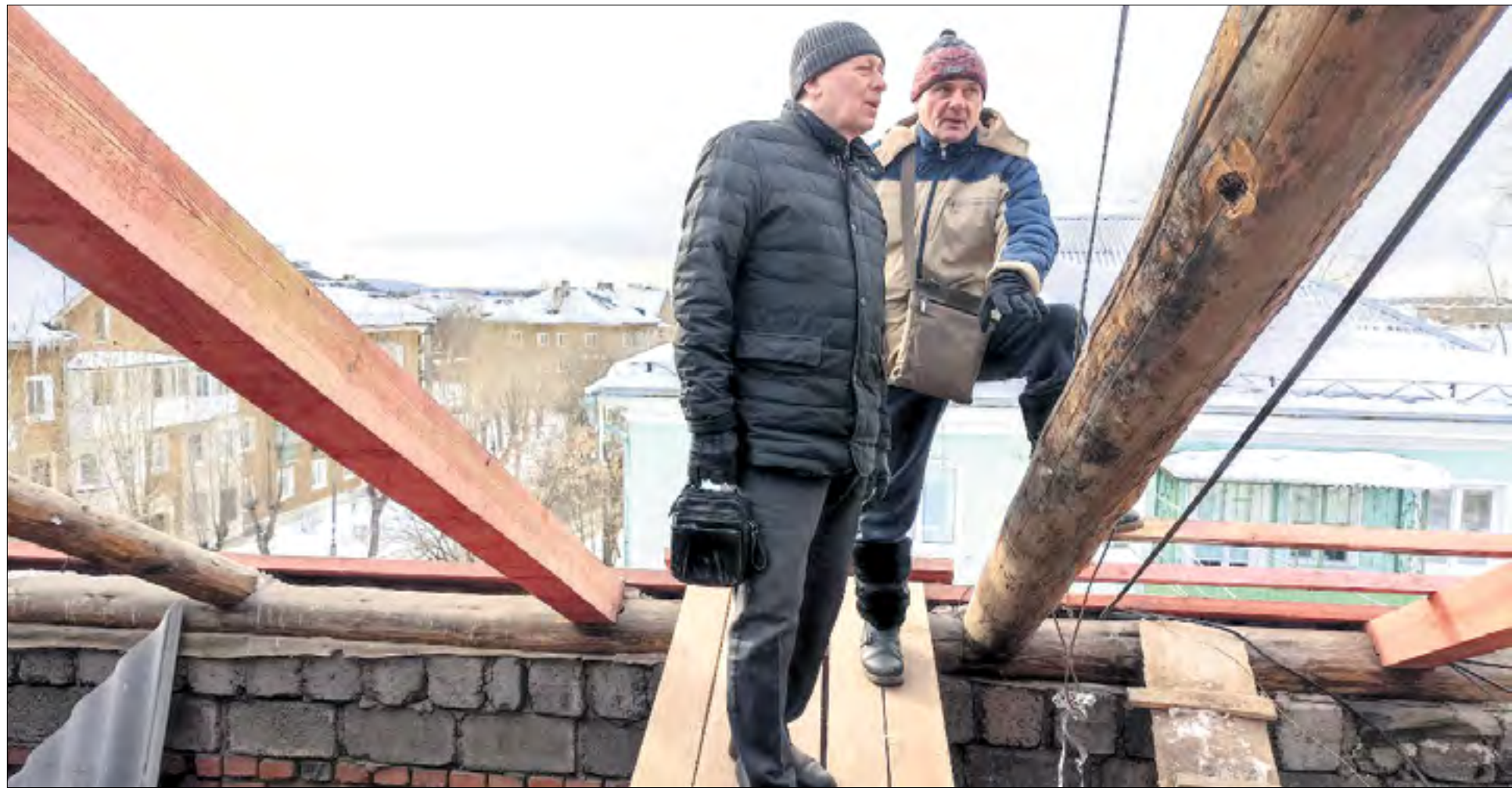
Это чердак дома №16 по улице Жуковского. Представитель подрядчика Дмитрий Заколюкин показывает замдиректора УГХ Сергею Филиппову, какой объем работ уже выполнили строители — он оказался намного больше, чем планировалось. // Фото Ольги Вертлюговой
