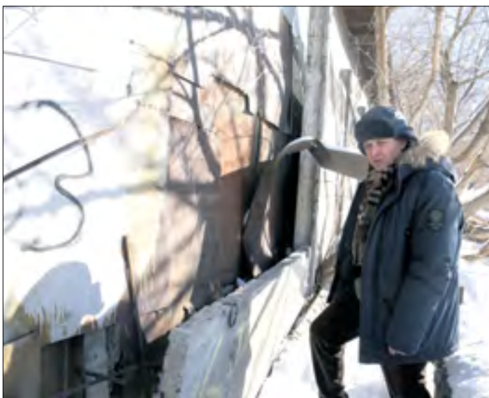
Александр Никитин показывает на пролом в стене склада, который пришлось заварить, чтобы преградить доступ на территорию детям. // Фото Владимира Коцюбы-Белых
