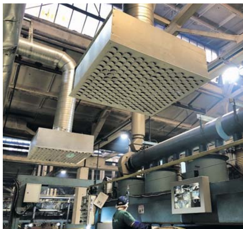
Установлена система воздушного душирования на местах
