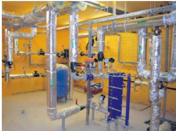
Тепловой пункт с автоматическим управлением
