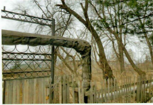
Рис. 4.104 Надземный переход теплотрассы над проездом
