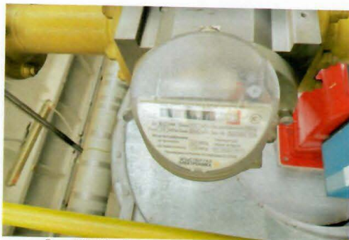
Рис. 4.21 Прибор учета расхода газа котла № 3
