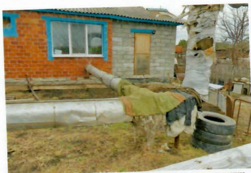
Рис. 4.137 Ввод в жилой дом. Разрушение теплоизоляции
