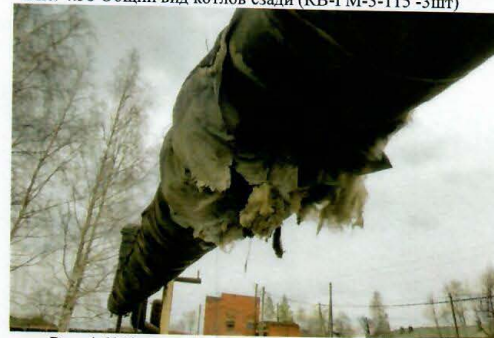
Рис. 4.60 Частичное разрушение теплоизоляции
