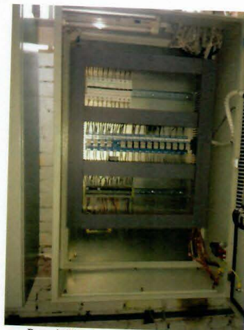
Рис. 4.42 Шкаф управления Котлом
