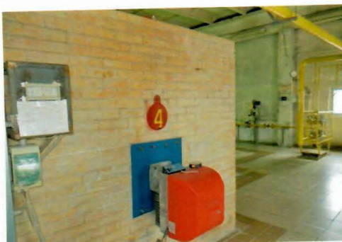
Рис. 4.86 Горелка дизельная котла №4
