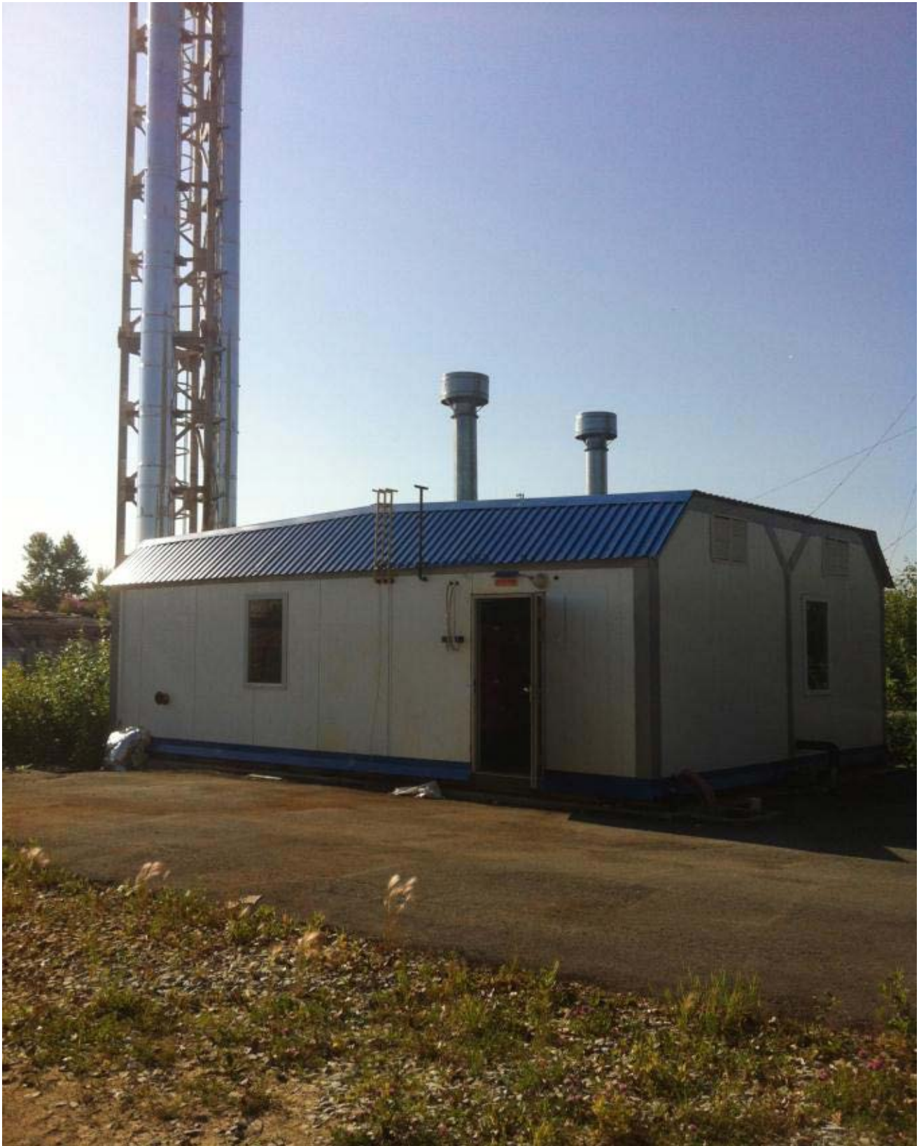
Газовая котельная г. Сысерть (ул. 4-й Пятилетки, 2а).
