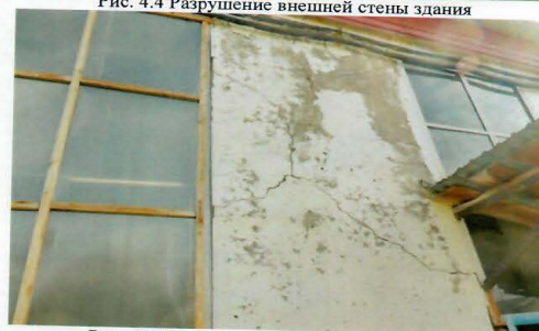
Рис. 4.6 Трещины по стене главного фасада
