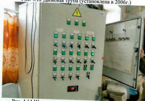
Рис. 4.14 Щит управления насосами и вентиляторами
