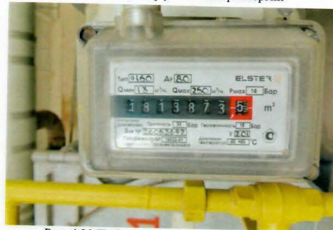
Рис. 4.20 Прибор учета расхода газа котла № 2
