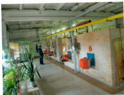
Рис. 4.85 Водогрейные котлы (4 шт.)
