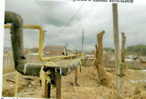
Рис. 4.34 Магистраль системы отопления надземная прокладка (местами нарушена теплоизоляция трубопровода)
