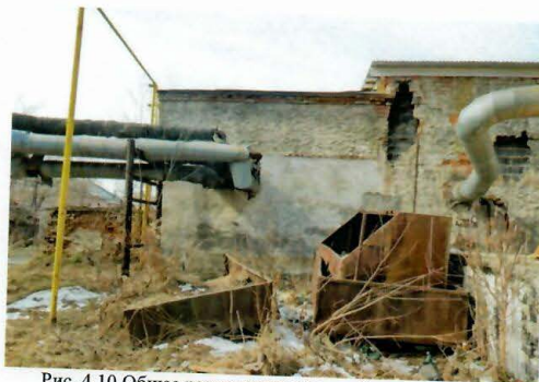
Рис. 4.10 Общее разрушении внешней несущей стены
