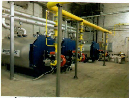
Рис. 4.57 Общий вид котлов (КВ-ГМ-3-115 -3шт)
