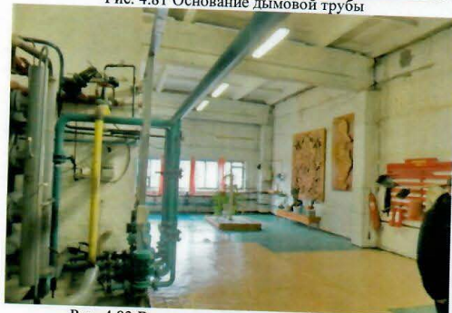
Рис. 4.83 Внутреннее помещение котельной
