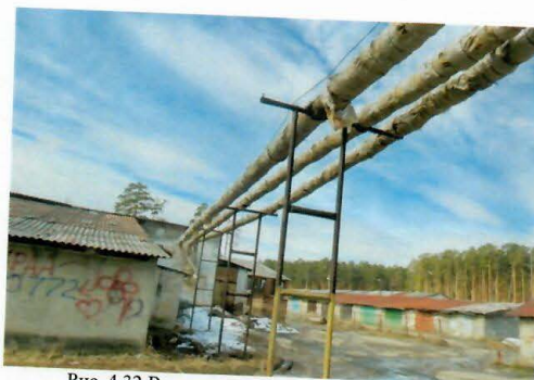
Рис. 4.32 Ввод теплотрассы в здание котельной
