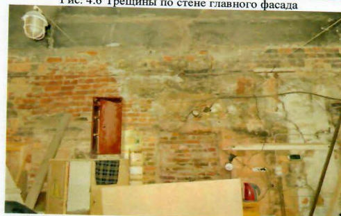
Рис. 4.8 Разрушение кирпичной кладки несущей стены
