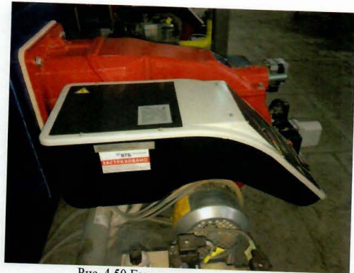
Рис. 4.50 Газовая горелка котла
