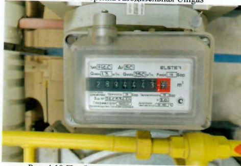
Рис. 4.19 Прибор учета расхода газа котла № 1
