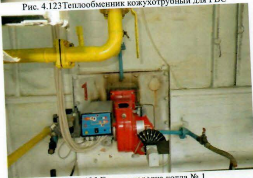
Рис. 4.125 Газовая горелка котла № 1
