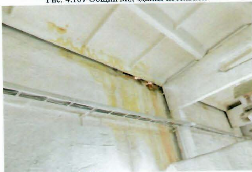
Рис. 4.109 Следы протекания кровли
