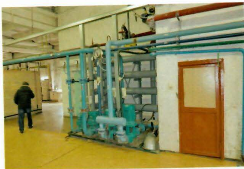
Рис. 4.93 Насосное оборудование котельной
