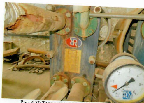
Рис. 4.30 Теплообменники ГВС пластинчатые
