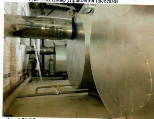
Рис. 4.58 Общий вид котлов сзади (КВ-ГМ-3-115 -3шт)
