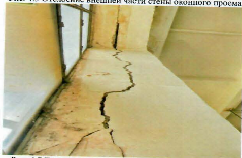
Рис. 4.7 Трещины по несущей стене внутри помещения
