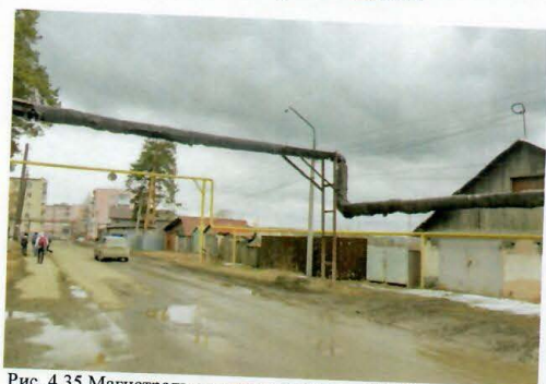
Рис. 4.35 Магистраль системы отопления Т1иТ2 проход НАД дорогой высота +3,8м.
