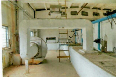
Рис. 4.110 Дымосос внутри помещения котельной
