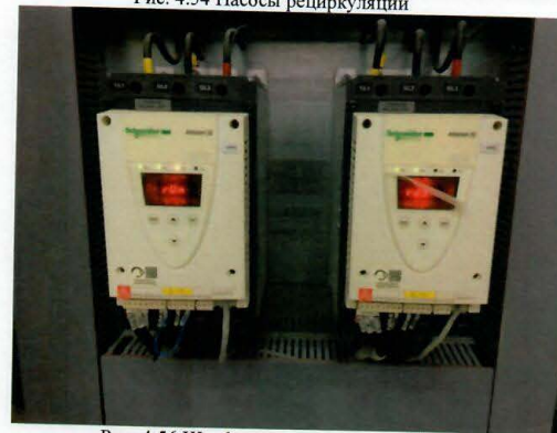
Рис. 4.56 Шкаф управления насосами
