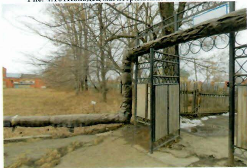
Рис. 4.103 Надземный переход теплотрассы над проездом
