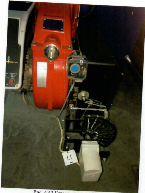
Рис. 4.43 Газовая горелка Котла
