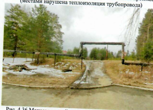
Рис. 4.36 Магистральный компенсатор системы отопления
