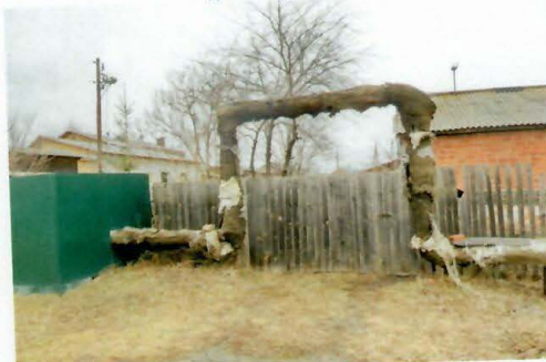
Рис. 4.134 Переход теплотрассы над проездом к жилому дому
