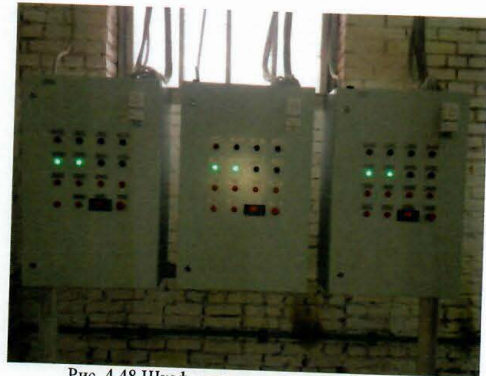
Рис. 4.48 Шкаф управления котлами (3шт)
