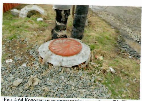
Рис. 4.64 Колодец магистральный тепловой сети Т1иТ2
