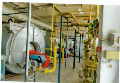
Рис. 4.13 Котлы КВ-ГМ-3-115 (3 шт.)
