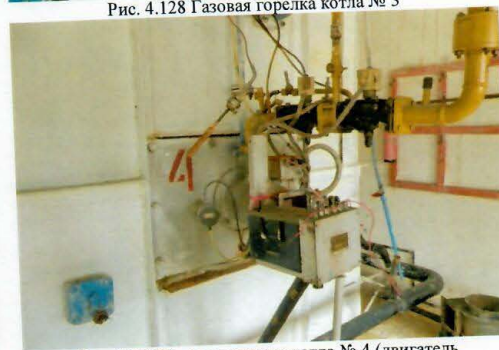
Рис. 4.130 Газовая горелка котла № 4 (двигатель демонтирован)
