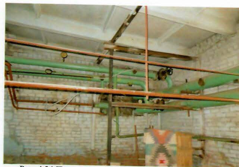
Рис. 4.24 Помещение под дизельную ёмкость (резерв)
