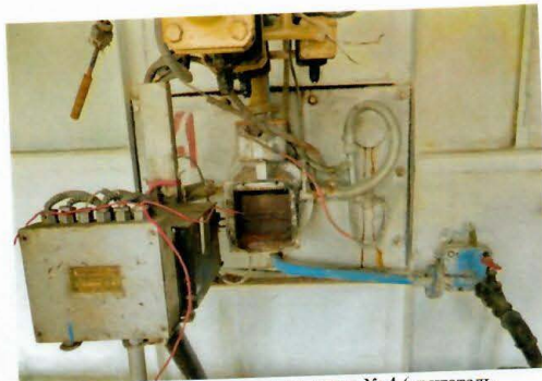
Рис. 4.132 Газовая горелка котла № 4 (двигатель демонтирован)
