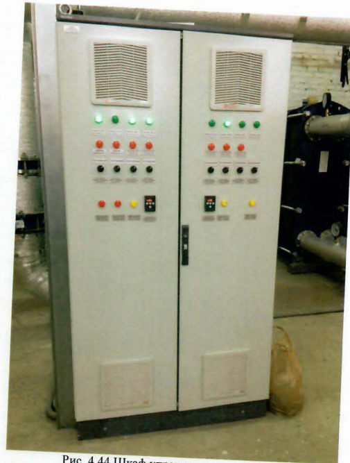
Рис. 4.44 Шкаф управления насосами
