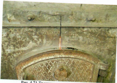
Рис. 4.71 Трещина угольного котла № 1
