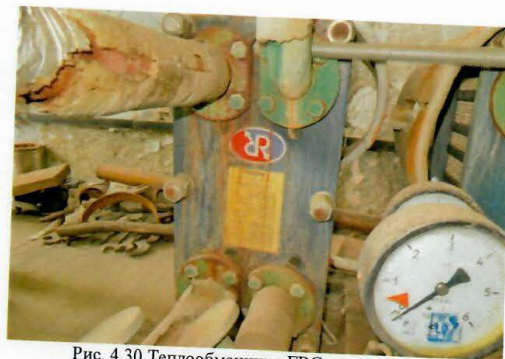
Рис. 4.30 Теплообменники ГВС пластинчатые
