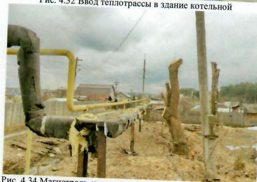
Рис. 4.34 Магистраль системы отопления надземная прокладка (местами нарушена теплоизоляция трубопровода)
