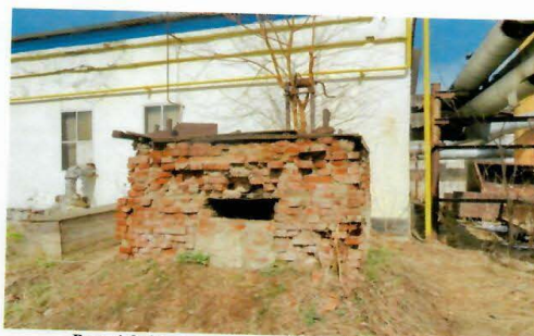
Рис. 4.2 Основание старой дымоходной трубы
