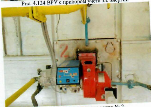
Рис. 4.126 Газовая горелка котла № 2
