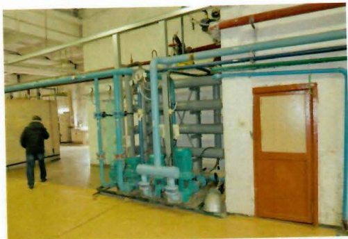
Рис. 4.93 Насосное оборудование котельной
