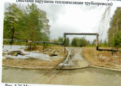
Рис. 4.36 Магистральный компенсатор системы отопления
