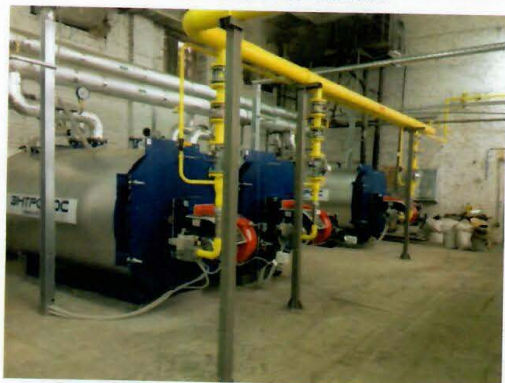
Рис. 4.57 Общий вид котлов (KB-ГМ-3-115 -3шт)
