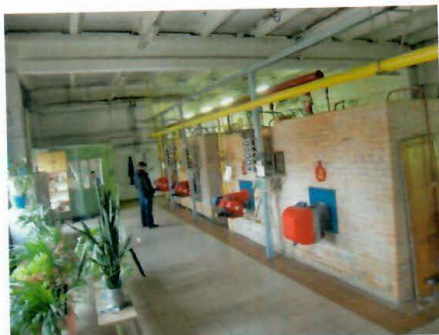
Рис. 4.85 Водогрейные котлы (4 шт.)
