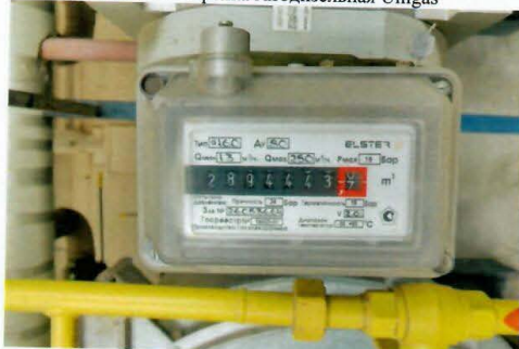
Рис. 4.19 Прибор учета расхода газа котла № 1
