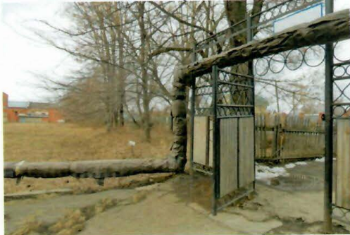
Рис. 4.103 Надземный переход теплотрассы над проездом
