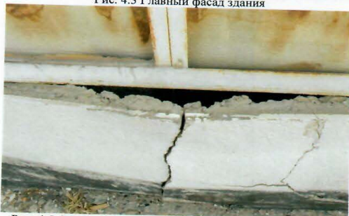
Рис. 4.5 Отслоение внешней части стены оконного проема
