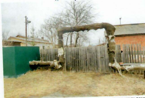
Рис. 4.134 Переход теплотрассы над проездом к жилому дому
