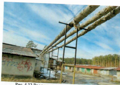
Рис. 4.32 Ввод теплотрассы в здание котельной
