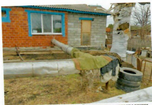
Рис. 4.137 Ввод в жилой дом. Разрушение теплоизоляции
