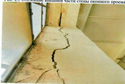
Рис. 4.7 Трещины по несущей стене внутри помещения
