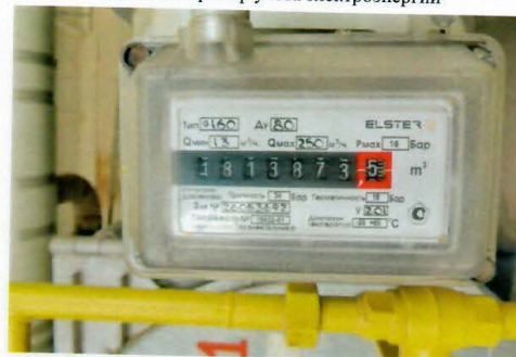
Рис. 4.20 Прибор учета расхода газа котла № 2
