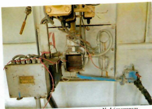
Рис. 4.132 Газовая горелка котла № 4 (двигатель демонтирован)
