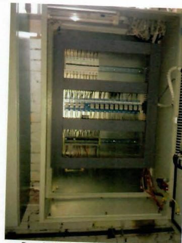
Рис. 4.42 Шкаф управления Котлом
