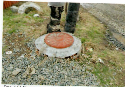
Рис. 4.64 Колодец магистральный тепловой сети Т1иТ2
