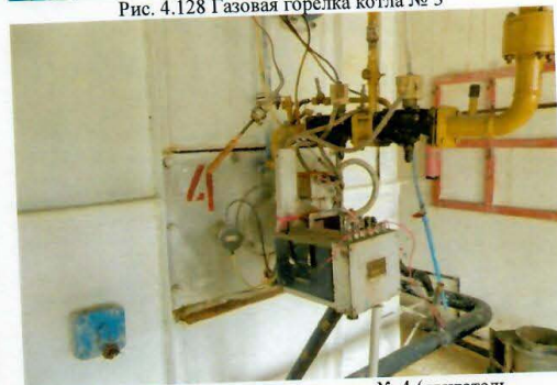
Рис. 4.130 Газовая горелка котла № 4 (двигатель демонтирован)
