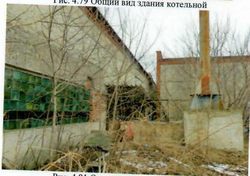
Рис. 4.81 Основание дымовой трубы
