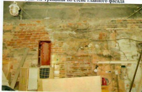
Рис. 4.8 Разрушение кирпичной кладки несущей стены
