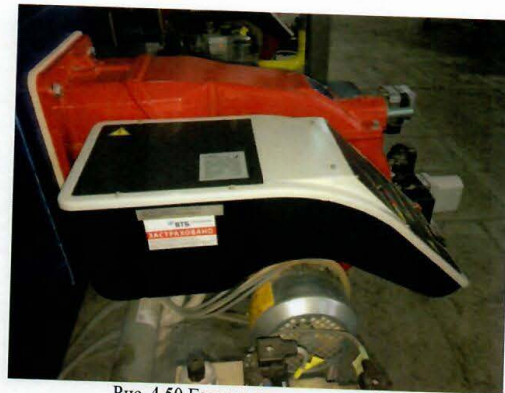
Рис. 4.50 Газовая горелка котла
