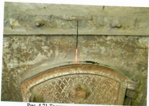
Рис. 4.71 Трещина угольного котла № 1
