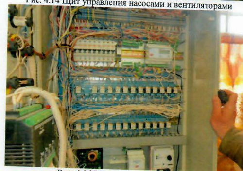
Рис. 4.16 Щит управления котлами
