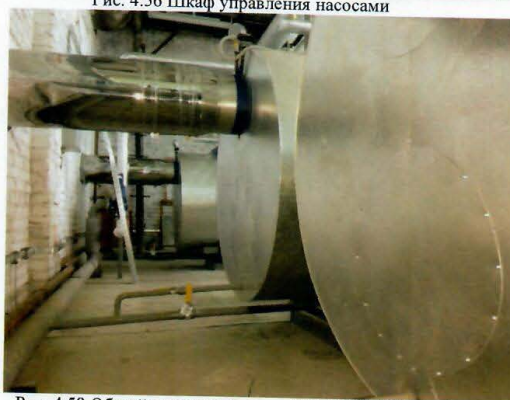
Рис. 4.58 Общий вид котлов сзади (KB-ГМ-3-115 -3шт)
