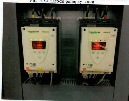
Рис. 4.56 Шкаф управления насосами
