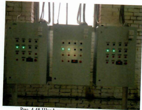
Рис. 4.48 Шкаф управления котлами (3шт)
