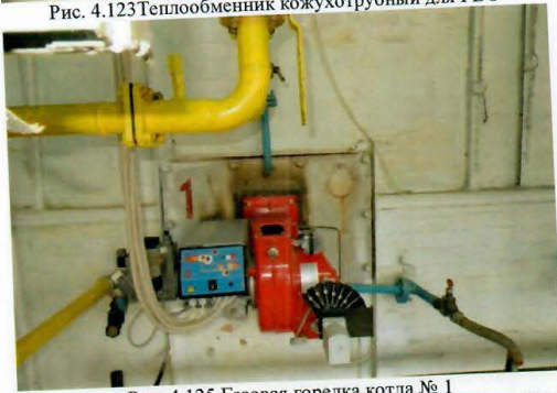
Рис. 4.125 Газовая горелка котла № 1
