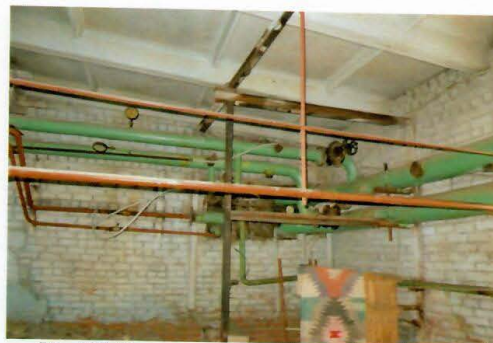
Рис. 4.24 Помещение под дизельную ёмкость (резерв)
