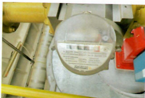
Рис. 4.21 Прибор учета расхода газа котла № 3
