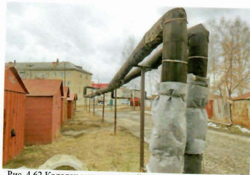
Рис. 4.62 Колодец магистральный тепловой сети Т1иТ2
