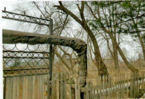
Рис. 4.104 Надземный переход теплотрассы над проездом
