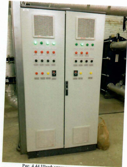
Рис. 4.44 Шкаф управления насосами
