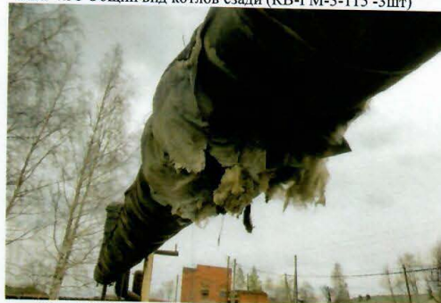
Рис. 4.60 Частичное разрушение теплоизоляции
