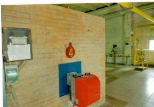
Рис. 4.86 Горелка дизельная котла №4
