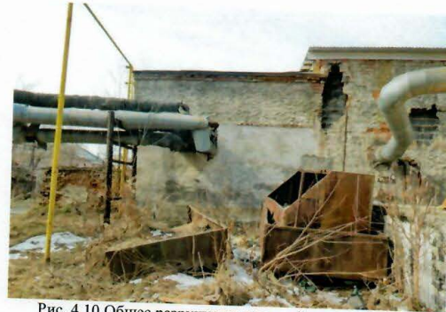
Рис. 4.10 Общее разрушения внешней несущей стены
