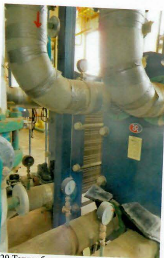
Рис. 4.29 Теплообменники отопления пластинчатые
