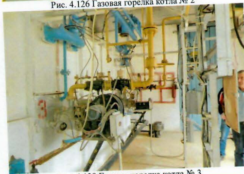
Рис. 4.128 Газовая горелка котла № 3
