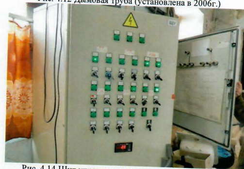
Рис. 4.14 Щит управления насосами и вентиляторами
