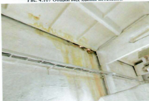
Рис. 4.109 Следы протекания кровли
