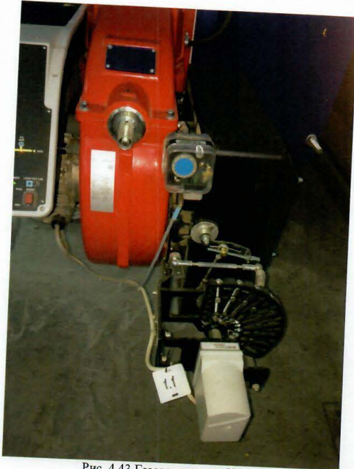
Рис. 4.43 Газовая горелка Котла
