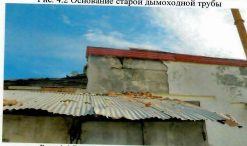
Рис. 4.4 Разрушение внешней стены здания
