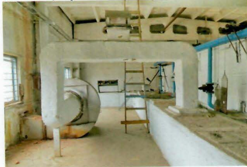
Рис. 4.110 Дымосос внутри помещения котельной
