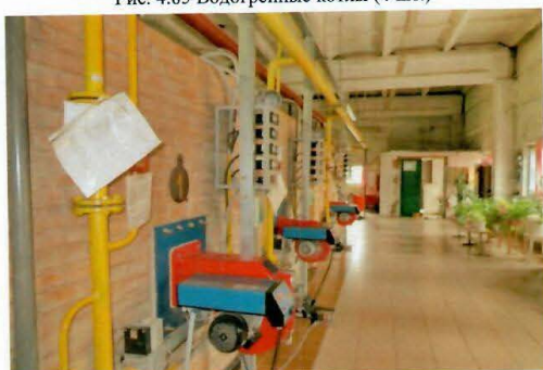
Рис. 4.87 Помещение с водогрейными котлами
