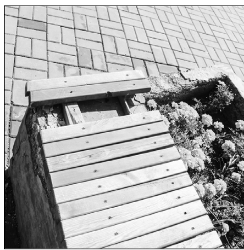
В клумбы попали остатки облицовочной плитки и строительный мусор
