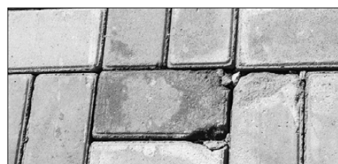
Тротуарная плитка под ногами начала крошиться и выпадать
