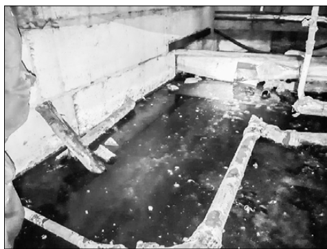
Аварийный засор канализации в подвале многоквартирного дома
