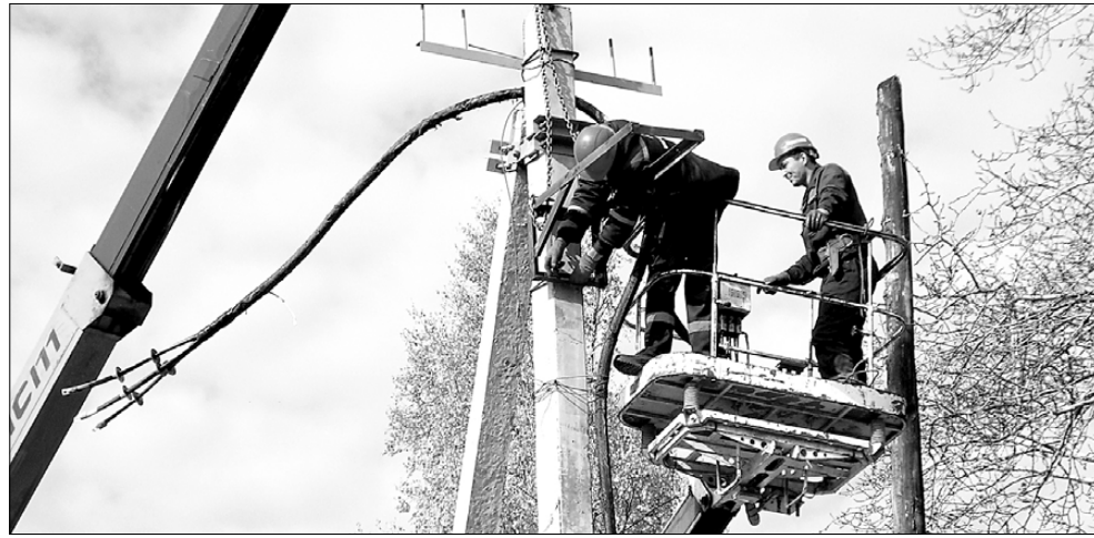
В южной части города энергетики реконструировали линию электропередачи. Под замену попали 4,2 километра сетей
