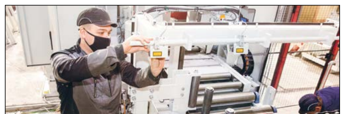
▲ Артём Тарасов, сервисный инженер «Мегатэк», проверяет установку датчиков
