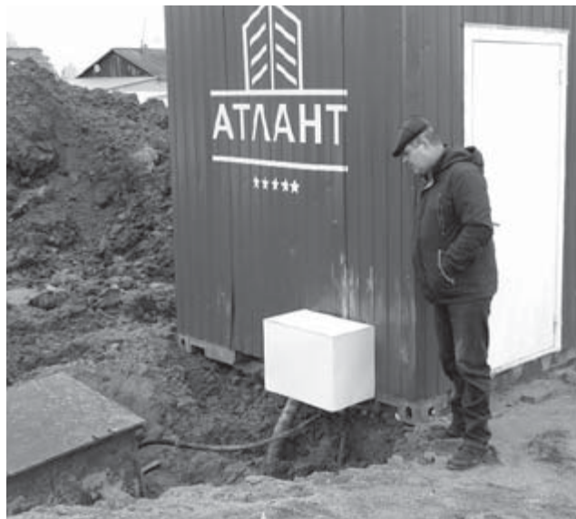
Михаил Кокшаров показал павильон с водоочистным сооружением
