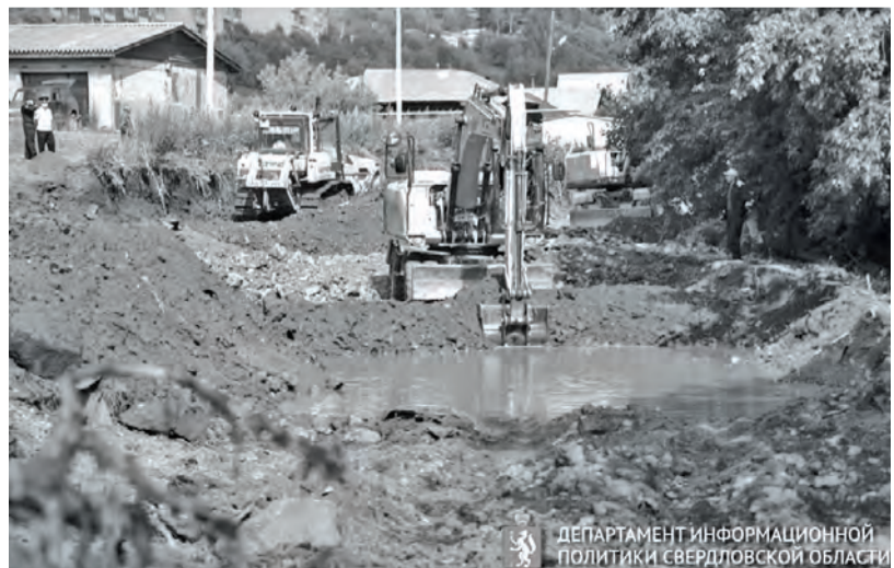
● Сразу после окончания ливня был введен режим ЧС, который будет сохраняться до полного завершения аварийно-восстановительных работ
