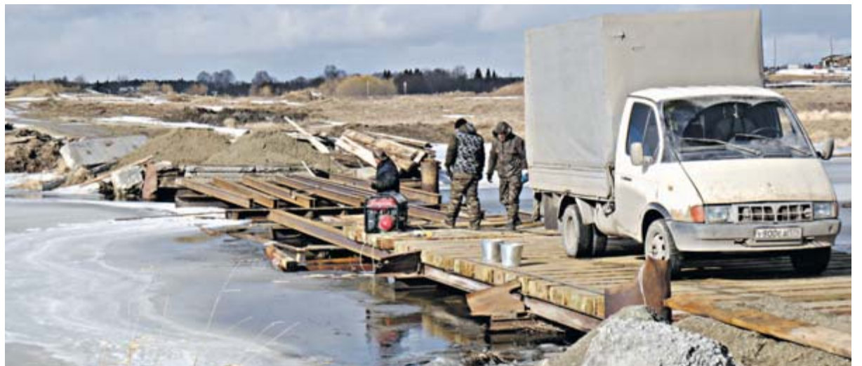
Мост должен быть отремонтирован до середины апреля
