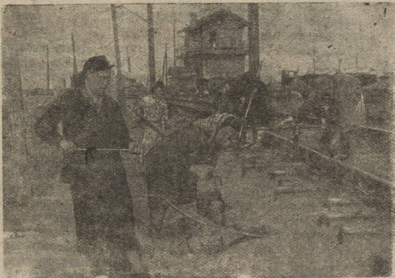
Кооперированная женская бригада путеобходчиков 1 отделения 1 околотка дистанции пути Свердловск-пассажирская за ремонтом пути. На снимке (слева направо): И. И. КОНЫШЕВА (бригадир), Б. Д. УИМИНА, Г. С. ФЕОКТИСТОВА, Н. В. ШУШУКОВА, А. Г. АНИКИНА и О. Т. УДАЧИНА. Фото А. Шаевича
