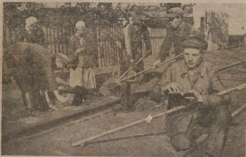
Бригада, где старшим ремонтным рабочим тов. Н. Ф. ТОКМАКОВ (Тюменская дистанция пути), ремонтирует путь методом суфляжа. Бригада работает на околотке дорожного мастера тов. Богоделова. Фото В. Ложина.
