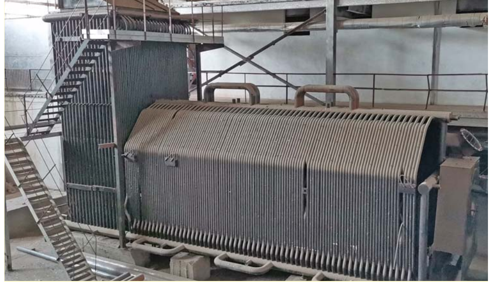
Водогрейный котёл без обмуровки.
