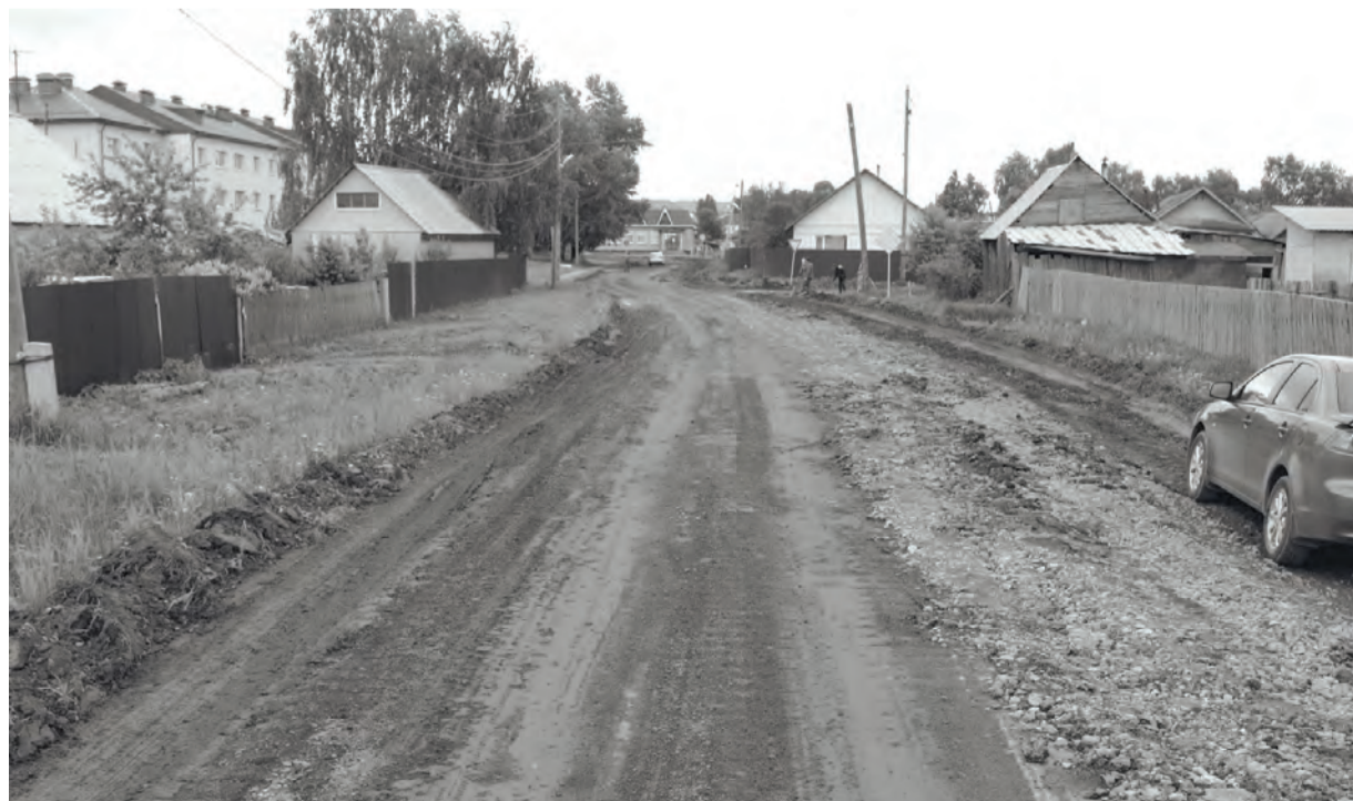
● С дороги по улице Тимирязева снят асфальт, идёт подготовка к капитальному ремонту
