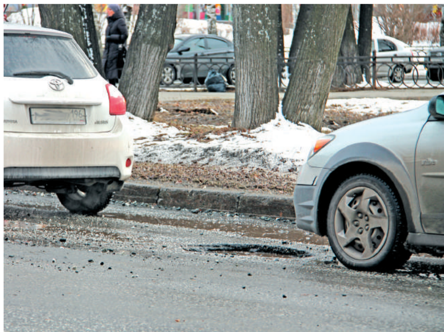
Разрушенное асфальтовое покрытие на перекрёстке улиц Ленина и Кирова.
