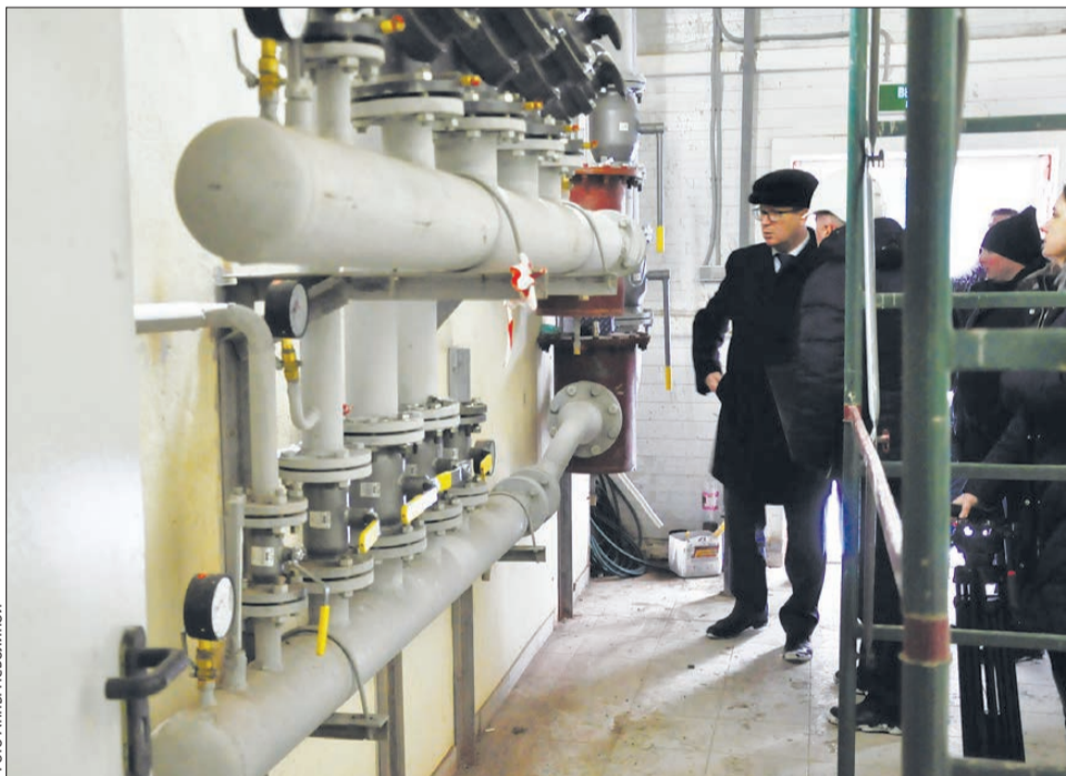
Насосно-фильтровальная станция обрастает оборудованием
