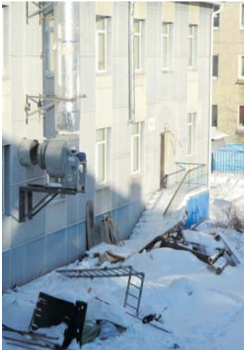
Вокруг соматик скопилось много строительного мусора
