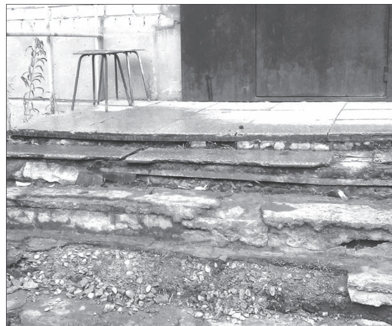
Крыльцо сейчас больше напоминает развалины римского Колизея, а не вход в благоустроенное жилище / ФОТО РЕДАКЦИИ ГАЗЕТЫ «ВРЕМЯ»
