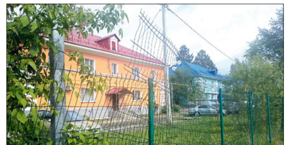
Ограждение спортооружения требует ремонта
