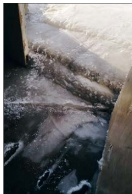
Сточные воды в доме № 11 по улице Заводской текут обратно в подвезд / ФОТО ИЗ СОЦИАЛЬНЫХ СЕТЕЙ
