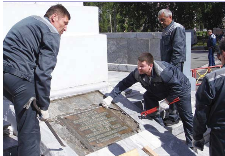
Демонтируют старую мемориальную плиту монтажники РСУ Александр Мочалов, Рафик Халиков и слесарь-ремонтник МЛЦ Иван Алексеев.
