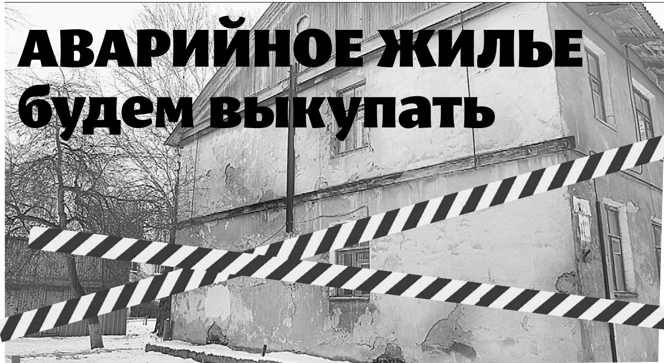
Дома на улице Пушкинской, признанные аварийными в октябре 2012 года, уже несколько лет стоят опоясанные металлической стяжкой
