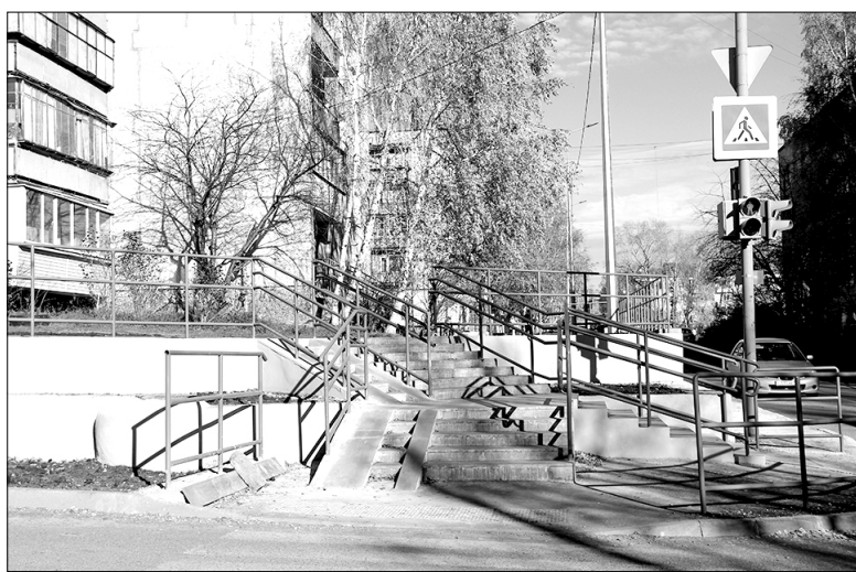
Ремонт лестницы и подпорной стенки напротив школы № 4 оказался самым основательным за всю историю ближайшей девятиэтажки
