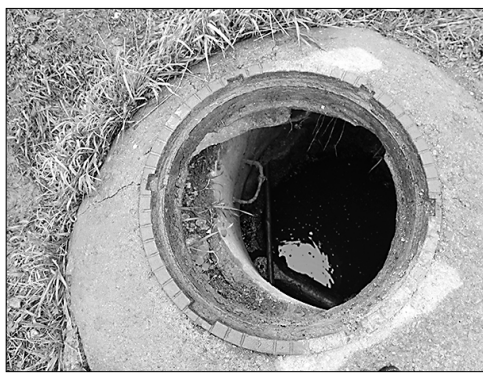
Канализация с трёх многоквартирных домов на улице Садовой собирается в коллектор
