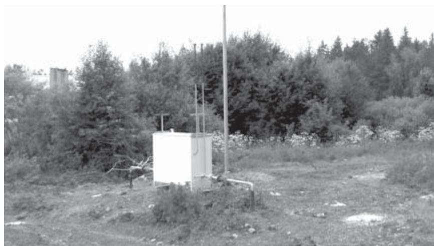
Газораспределительный шкаф в районе для СПК «Сибиряк»
