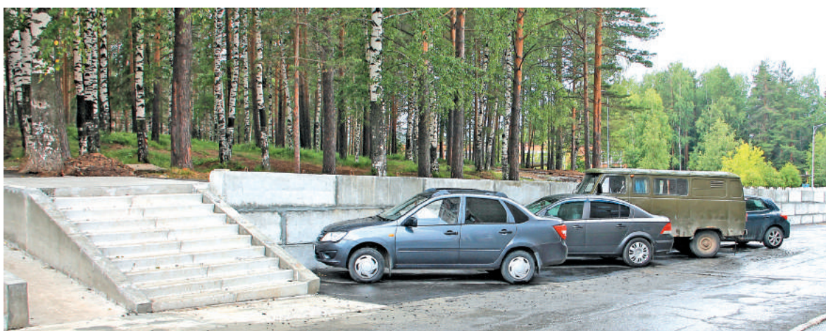
Устройство подпорной стены и обновлённая лестница с пандусом во дворе дома № 88 по улице Ленина.
