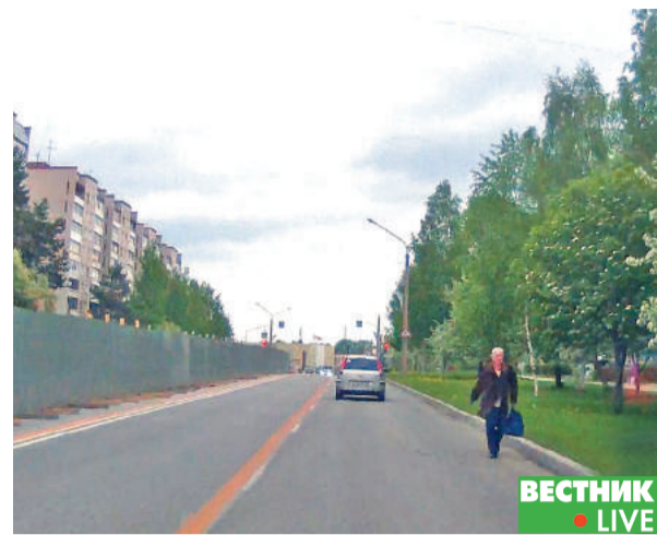
Ремонтные работы, сужение дороги, плотный трафик на участке, наличие тротуара? Некоторые пешеходы не ищут лёгких путей. Больше экстрима Богу экстрима!
