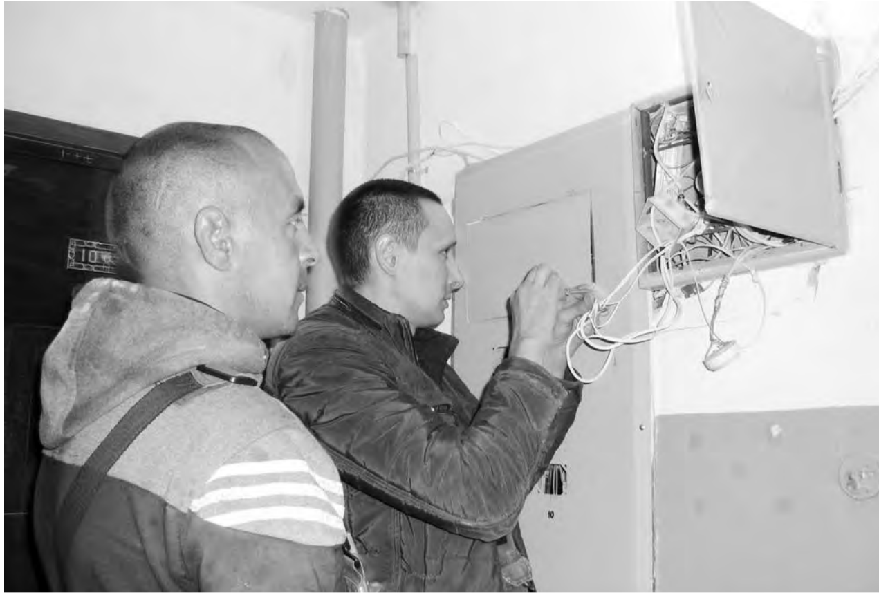
Совет дома на Энергостроителей, 3, подписал допсоглашение с управляющей компанией ООО «ЖКХ-Холдинг» на установку нового домофонного оборудования с условиями: деньги на установку – с текущего ремонта и никакой абонентской платы после. УК наняла подрядчика. «Сотрудники «Планеты связи» в понедельник, 17 июня, приступили к работе.
