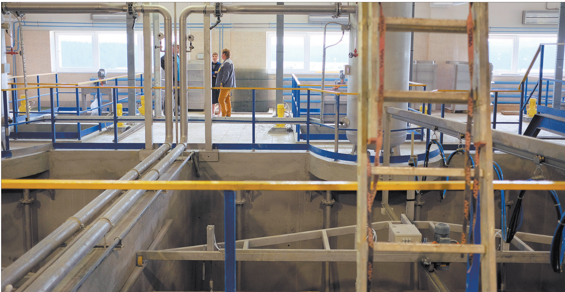
В этих восьми бассейнах глубиной семь метров воду взбалтывают, перемешивают, чтобы потом грязь поднялась вверх. Ее снимают специальными скребками, а воду отправляют на вторую очередь очистки — песчаные фильтры. По технологии, вода очищается в два этапа.
