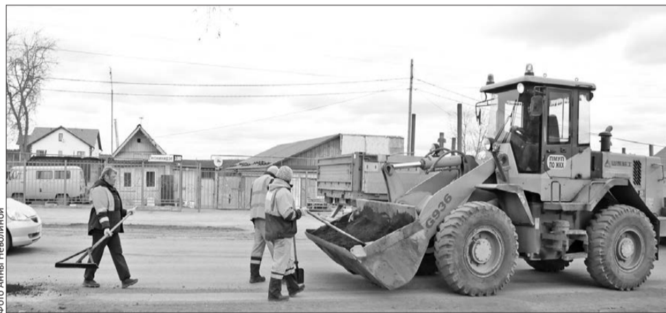
Заплатки из асфальта на пути следования колонны
