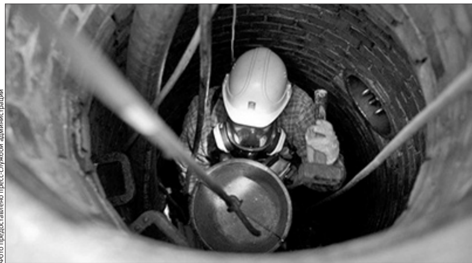
Чего только не находят в системе водоотведения!
