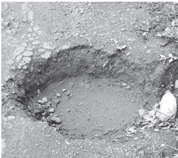
Колодец-ловушка на улице Декабристов. ФОТО АВТОРА
