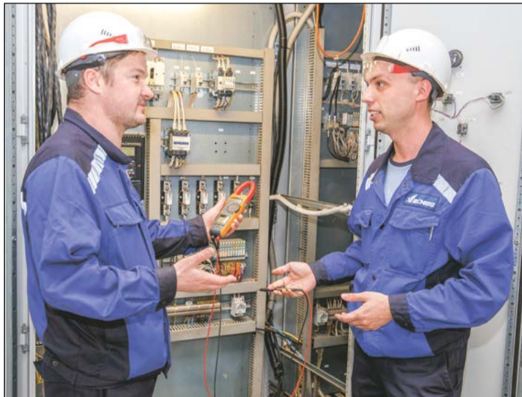
Дмитрий Устюжанин и Илья Шильчиков настраивают привод рабочего хода гарнисажной печи № 3
