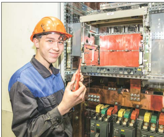
Электрики цеха № 6 проверяют новые трансформаторы, которые придут на смену старым
