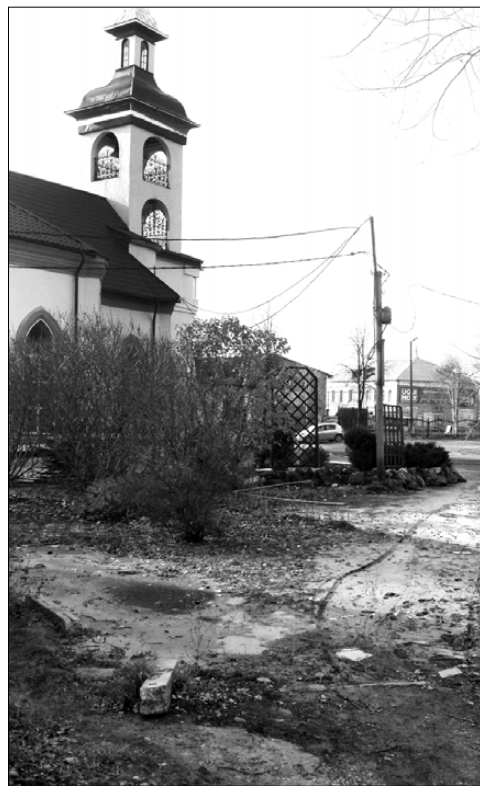
Через месяц после ремонта канализационных сетей во дворе храма опять потекли зловонные ручьи
