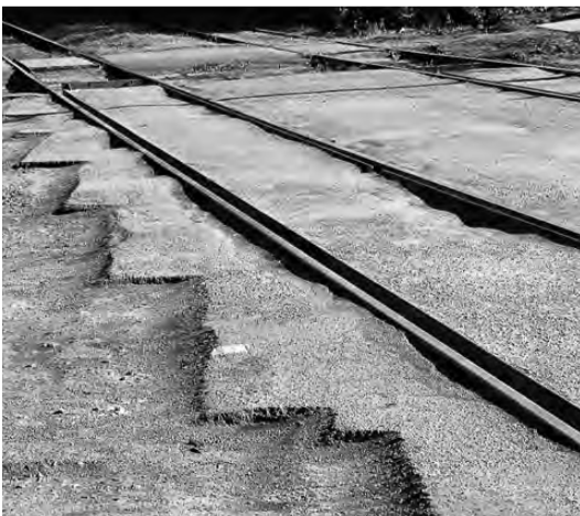
Плотно между рельсами давно разрушилось...
