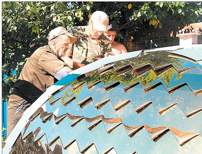
Бригада жестянщиков из села Полдневая покрывает купола листами с напылением нитрида титана
