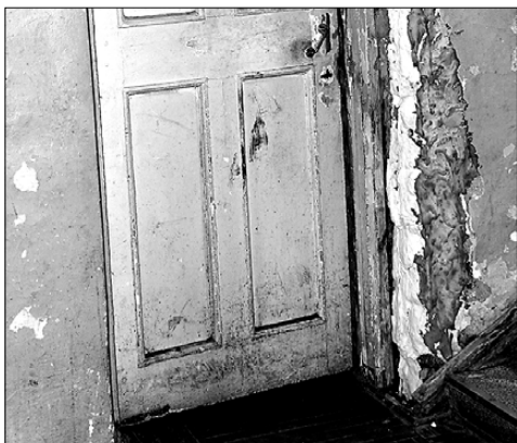
Возле дверей в душ разрушен косяк
