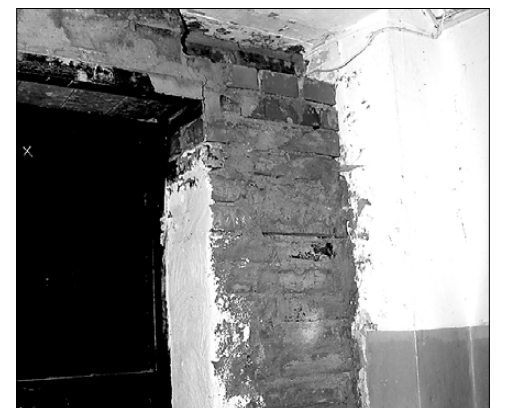
Пространство вокруг наружных дверей не успели оштукатурить
