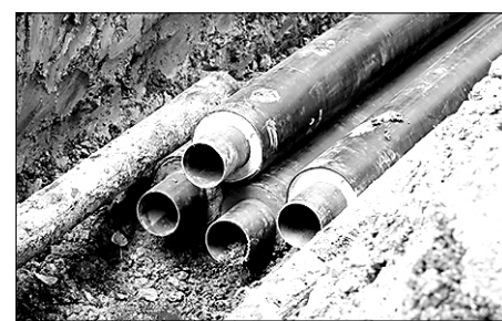
Ветхие трубы заменяют на трубы в оболочке из пенополиуретана, что позволит улучшить качество теплоснабжения многоквартирных домов
