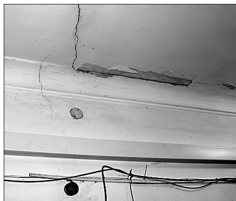
По потолкам и стенам внутри помещения пошли трещины
