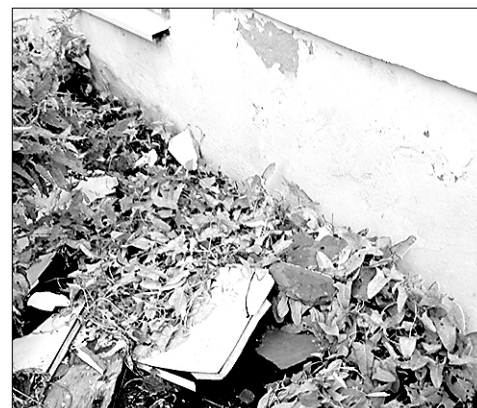
Недавно оштукатуренные фасады покрылись трещинами, штукатурка отваливается кусками
