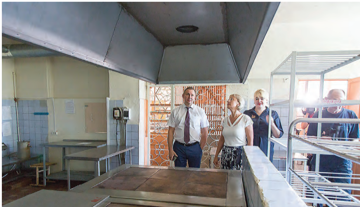
Владиславу Пинаеву показали пищеблок, где за счет питающей организации установлена новая система вентиляции с мощной вытяжкой.
