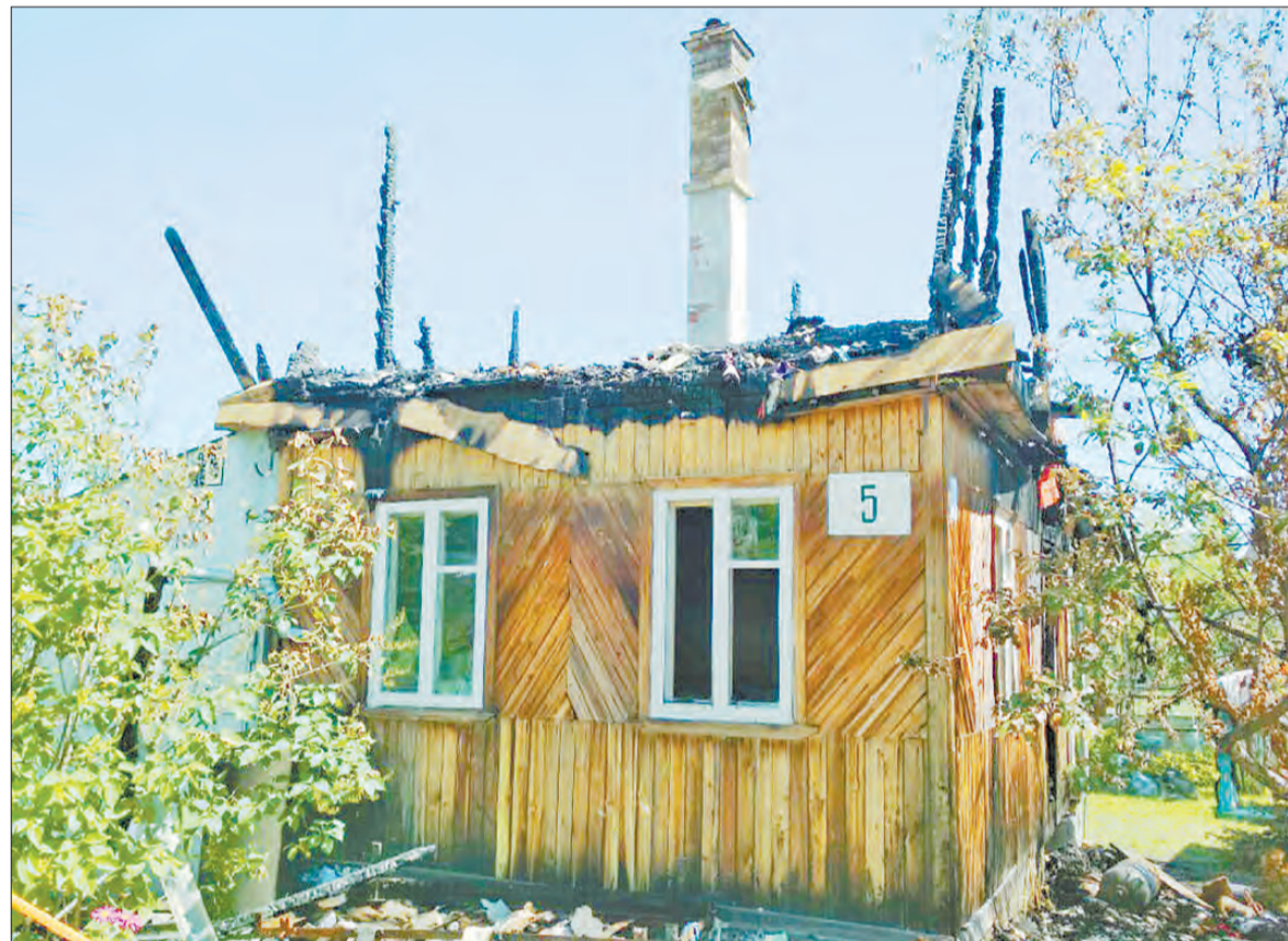
Несмотря на жаркую погоду, в садовом доме затопили печь, поскольку семья приезжала отдохнуть с маленьким ребёнком. И, вероятно, чтобы избавить дачу от сырости
